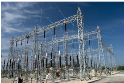
Subestación Bolívar a 500 mil voltios, ubicada en el municipio de Santa Rosa de Lima Foto. www.isa.com.co
